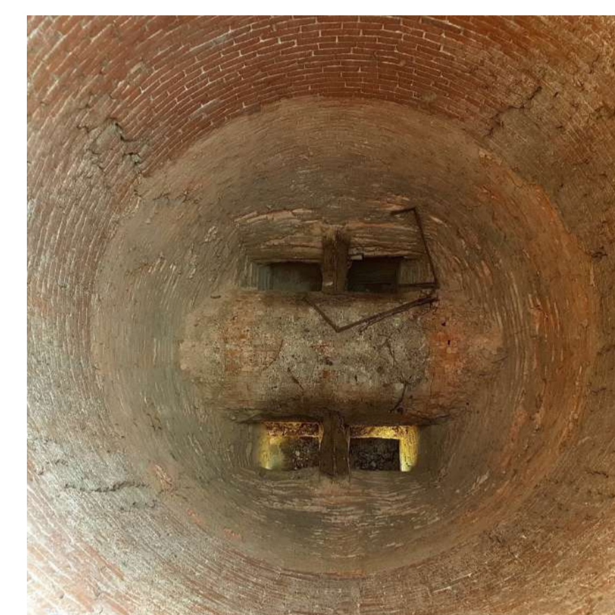
Le fond du four vu de dessus
